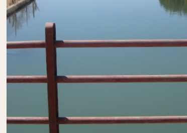
4. Κανάλι μεταφοράς νερού Water transfer canal
