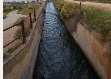
3. Κανάλι μεταφοράς νερού Water transfer canal
